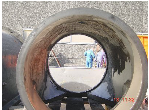
上圖：顯示受損的管道內部
