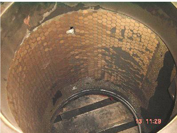
上圖：顯示管道內部陶瓷防磨磚及使用 UPS240 修復五年後仍正常工作的狀況。
