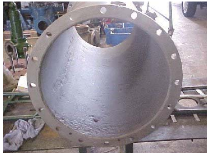
內部表面皆發生銹蝕及氣蝕的現象
