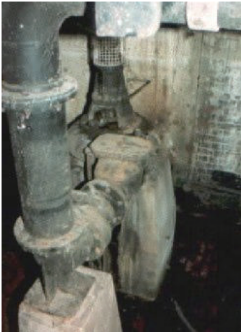
管道系統嚴重老化鏽蝕
